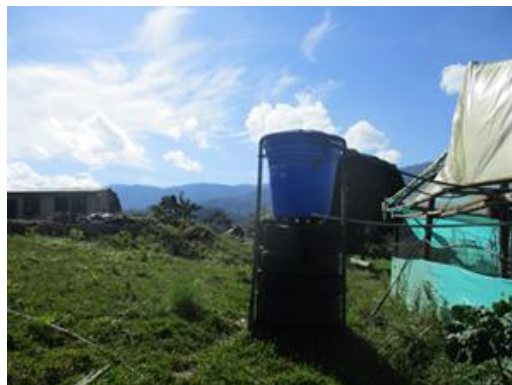
Fotografía 3.3 Sistema de acueducto veredal en las unidades territoriales
