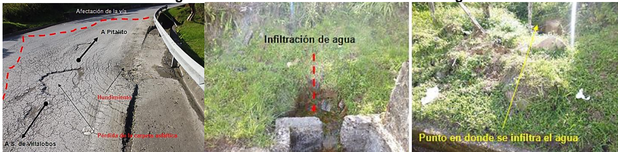
Figura 2.24 Estado de la vía e infiltración de agua
