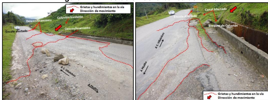
Figura 2.22 Afectación de la banca de la vía
