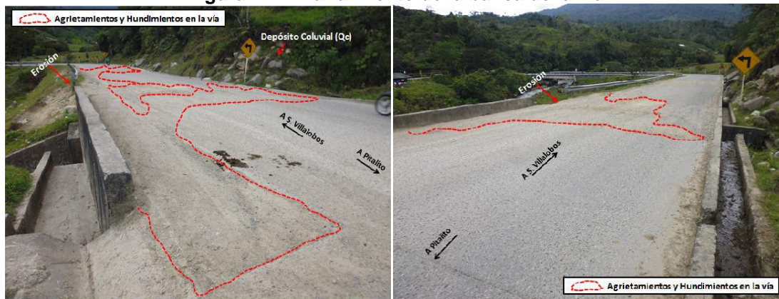
Figura 2. 11 Hundimiento de la banca de la vía
